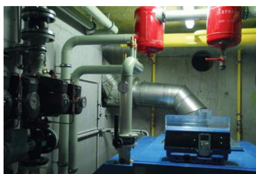
CARNEAU RACCORDÉ EN PRH INOX SUR CONDUIT ISOLÉ INOX PTR30
